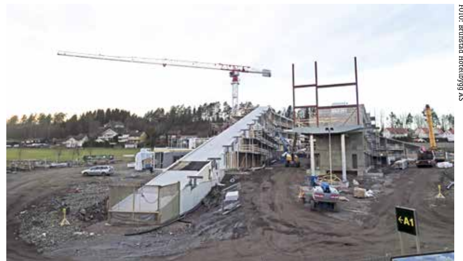
De nye hotellbyggene tar fort form når byggingen først er i gang.
